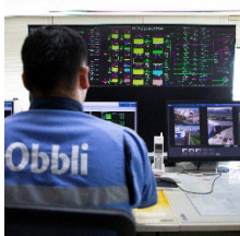
コントロールルーム での監視業務
